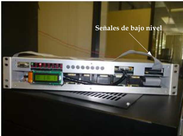
C) Acceso a señales de bajo nivel en relevador SEL 300G.
