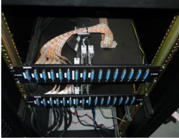
A) Módulos de conexión entrada/ salida de canales analógicos/digitales.
